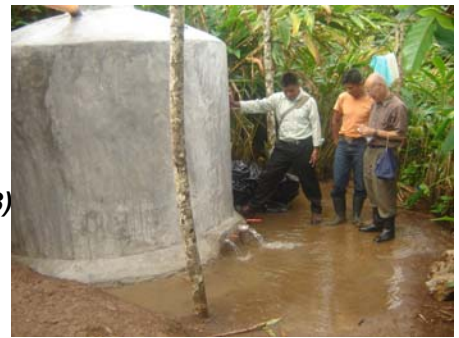
Agua manando de uno de los depósitos construidos
